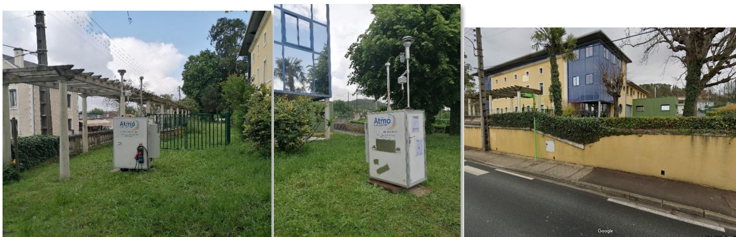
Figure 4 | Cabine mobile installée avenue Grandou à Trélissac
