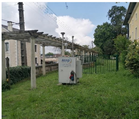
Cabine mobile installée avenue Grandou à Trélissac
