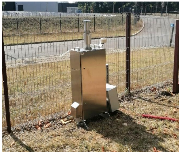
Figure 5 : préleveur de métaux installé sur le site "Ampère"
