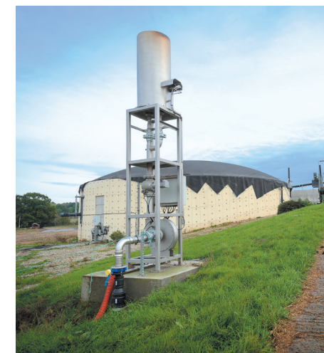
La torche est mise en fonctionnement pour des raisons environnementales et de sécurité lorsqu'il faut détruire le biogaz.
