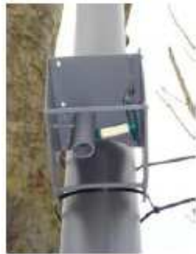
Figure 3 : échantillonneurs passifs placés sous leur abri de protection
